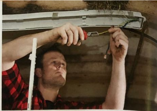
In een lasdoos komen de draden van de diverse ledbalken samen om naar de schakelaar te gaan.
